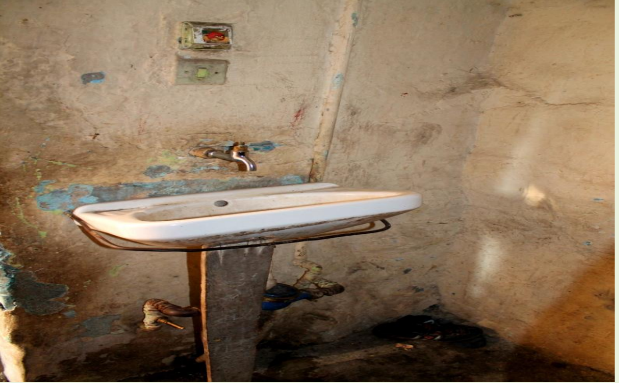
Soldaki fotoğrafta tuvaletten mutfağa geçiş. Bu durumdaki evlerin bir çoğu için yaklaşık 250 tl kira veriyorlar. Bu evlerde yaşayanlar bile kendilerini şanslı saymaktadırlar.
